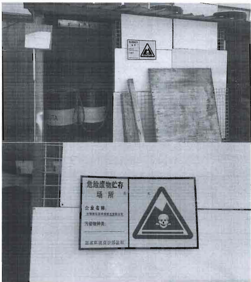
危废贮存场所照片
